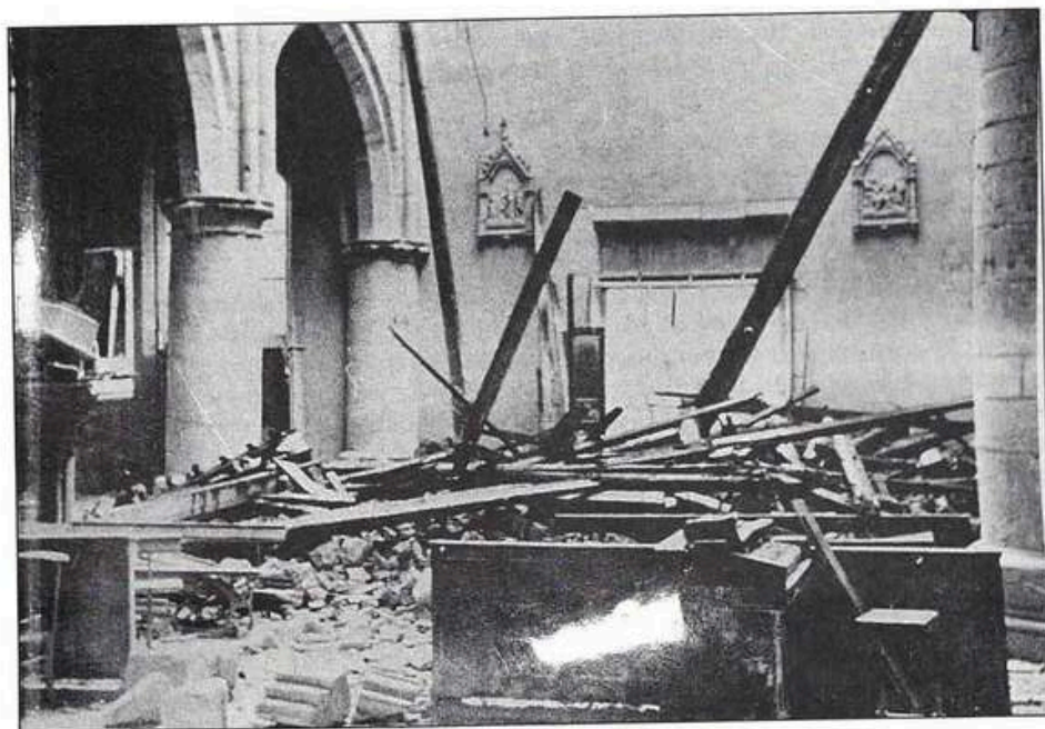
Voûtes et charpente sont effondrées et les débris jonchent la nef.
